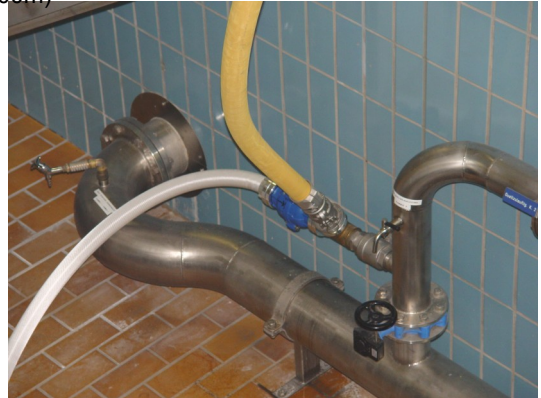
Lufteinspeisung in der Wasseraufbereitungsanlage
