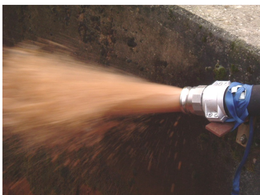
Rohrnetzspülung-Rohwasser: Spülwasserauslass mit einem flexiblen Rohr
