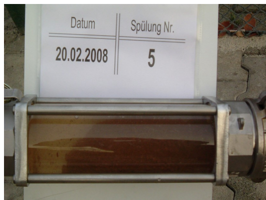
Rohrnetzspülung: Schauglas zur Fotodokumentation der Spülung
