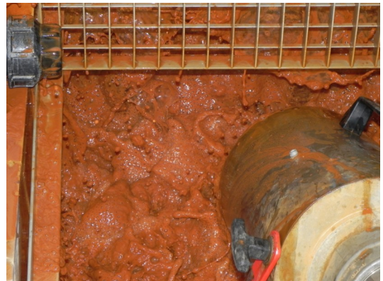
Spülwasserauslass im Hochbehälter (in den Entleerungsschacht)
