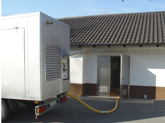
Lufteinspeisung in der Wasseraufbereitungsanlage
