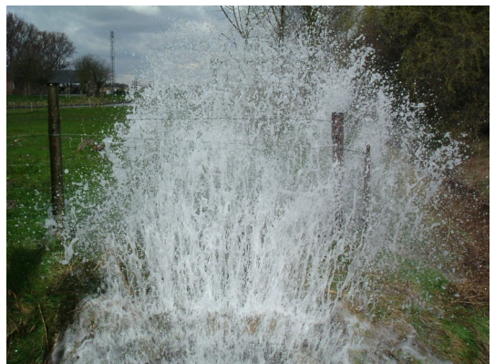
Spülwasserauslass über Entleerungsanschluss (Froschklaappe)
